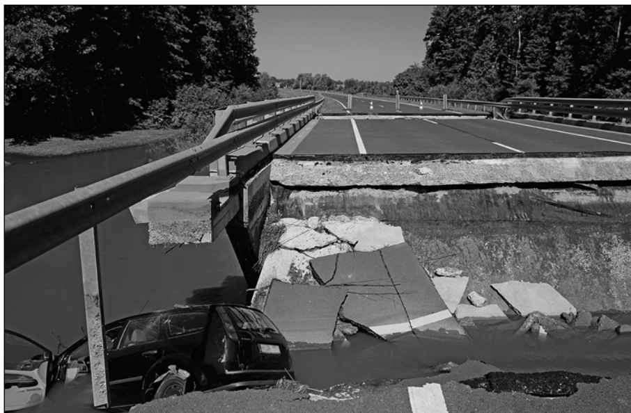
4. számú ábra: A megrongálódott közúti híd a Babócsai-Rinyán. Forrás: A szerzők saját szerkesztése
